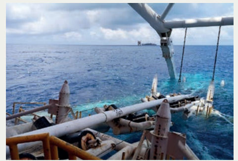
Die im Zap-Lok™-Verfahren zur Pipeline verpressten Rohre werden auf einer Strecke von 60 km im südchinesischen Meer verlegt.
