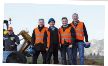
2. Italien V.I.: Andrea Jachetti (Sintertec srl), Vincent Bertolone, Domenico Tinaro, SGI Italien und Michael Kosfeld, bei Verlegearbeiten an einer Gas-Hochdruckleitung
